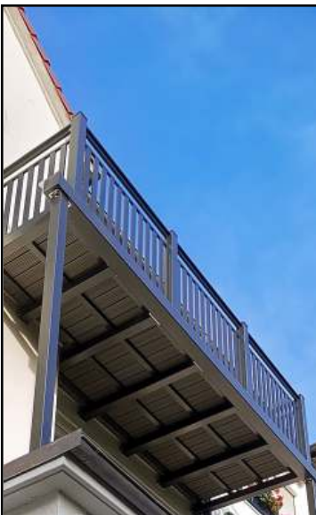
Balkon mit Staketengeländer, Stab „60“ freilaufender Handlauf
